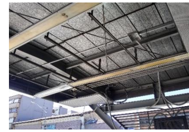
Figura 59 Estructura en mal estado
