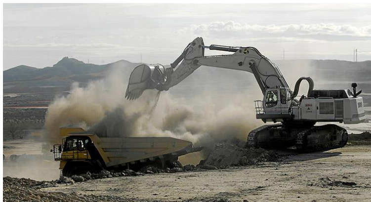
Figura 17. Polvo producido por maquinaria de construcción, (Obras Urbanas, 2014)
