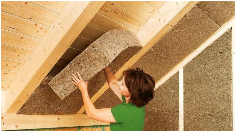
Ilustración 53 Instalación del sistema de aislamiento acústico. (Mantenimiento y Construcción de Casas en Madera, 2019)
