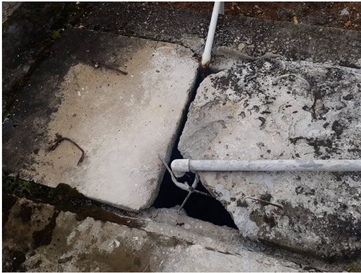
Figura 7. Entrada Tubería a tanque de abastecimiento de agua a la comunidad
