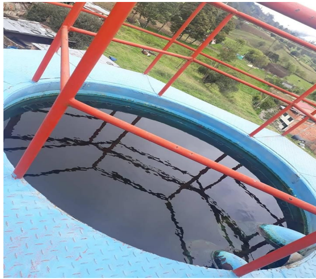
Figura 4. Tanque llegada Agua
