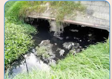
Presencia de basuras
