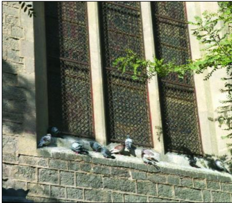
Fotografía de una ventana afectada por la erosión química por las deposiciones de las aves que contienen pH ácido atacando partes metálicas pétreas y arcillosas.
