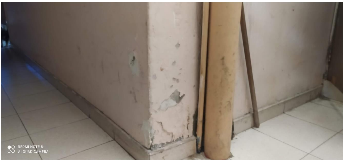
Figura 12. Edificaciones con humedad Carrera 69 # 64 37 barrio la estrada Bogotá
