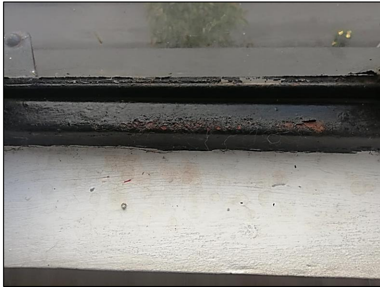
Fotografía de una ventana afectada por la patología de corrosión diferencial
