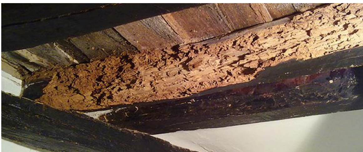
Figura 41. Viga de madera atacada por insectos xilófagos
