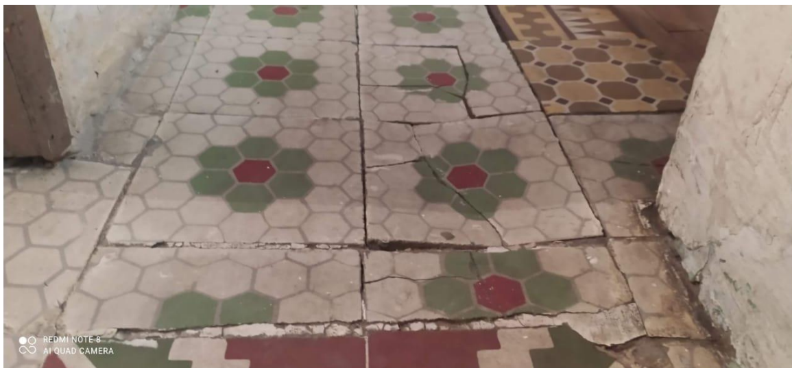
Figura 13. Edificaciones con daño estructural en placa, Carrera 69 # 64 37 barrio la estrada Bogotá
