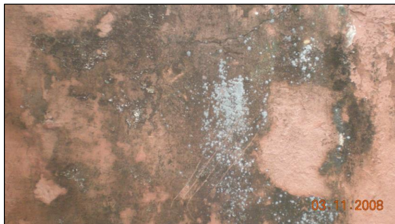
Figura 20. Humedad en una estructura.
