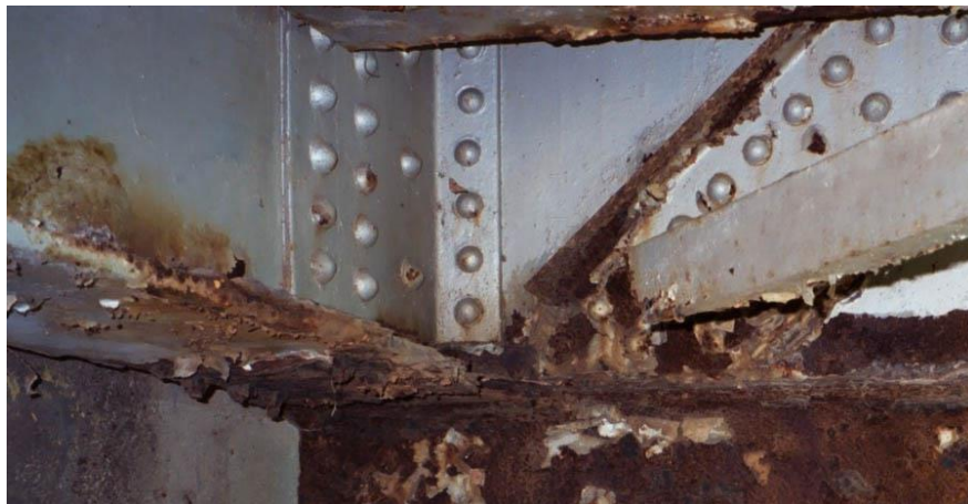
Patología por Oxidación y corrosión de una estructura metálica
