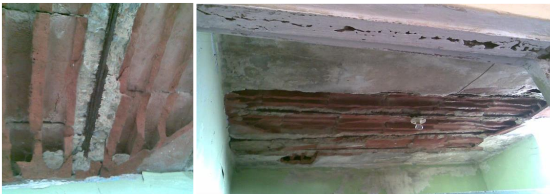
Figura 44. Patología de corrosión en la estructura
