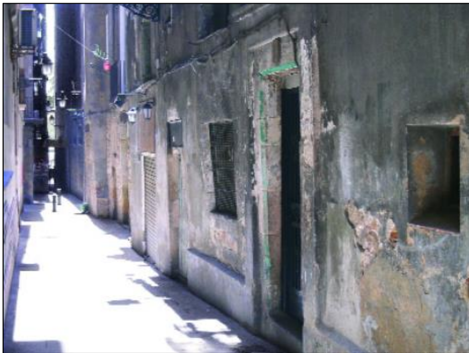
Esquema de una alteración extrínseca por falta de soleamiento en calles estrechas causa humedad en exceso
