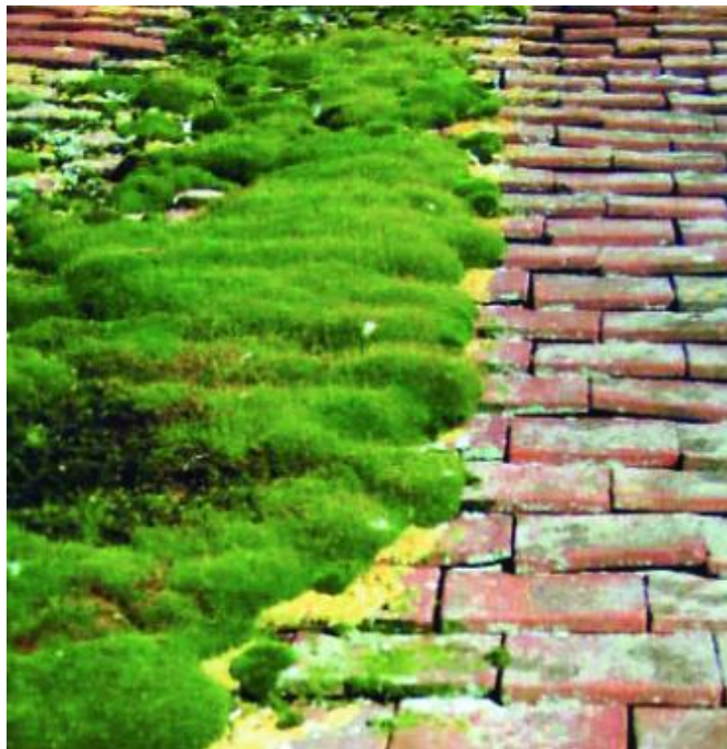
Figura 38. Factores Químicos – Erosión Química
