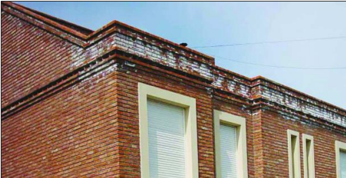
Esquema de afectación de una fachada de ladrillo por acción de la eflorescencia
