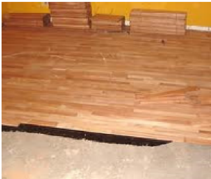
Figura 26. Foto de piso flotante.
