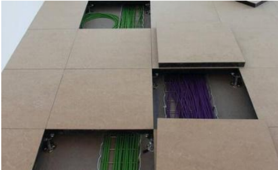
Figura 28. Foto de Piso Técnico elevado y visualización de cableado. Fuente: https://www.ducon.com.co/productos/arquitectura-interior/pisos-tecnicos .
