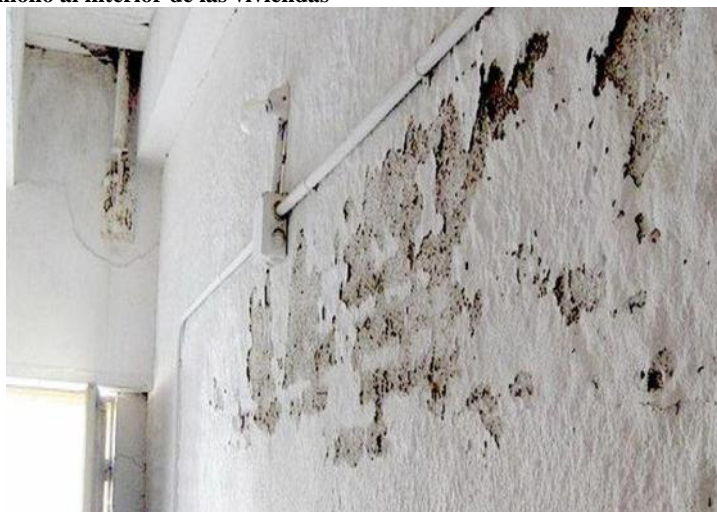
Figura 34. Presencia de humedad y moho al interior de las viviendas
