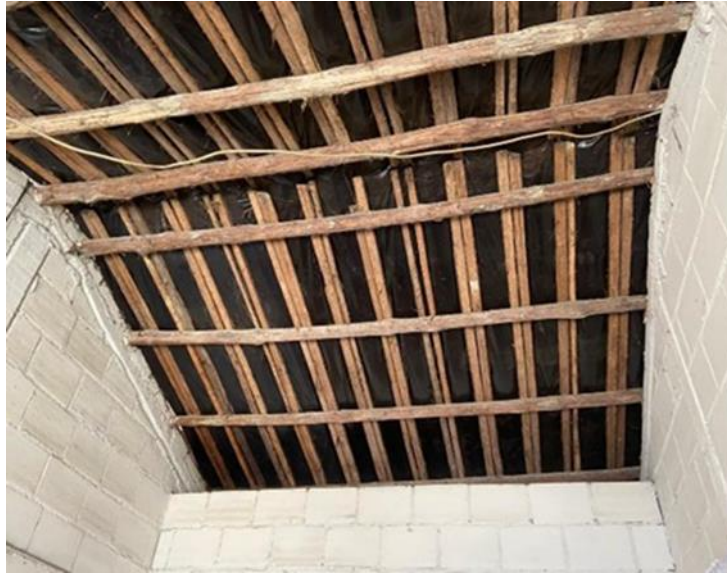
Figura 36. Viviendas sin presencia de cielo raso
