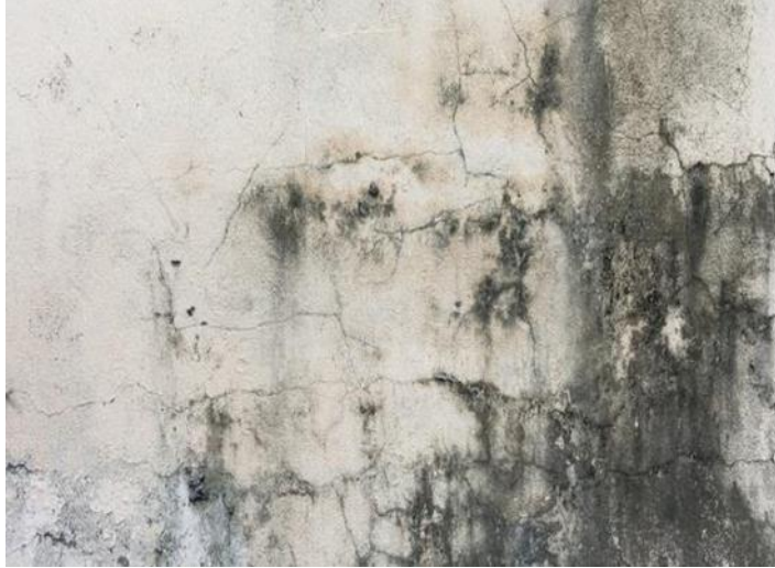
Figura 35. Presencia de humedad y moho al interior de las viviendas
