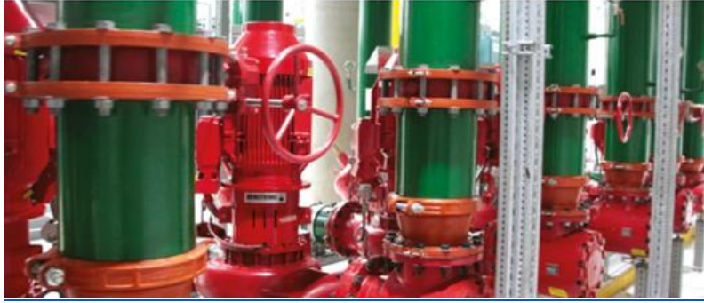
Figura 7. Sistema de bombeo
