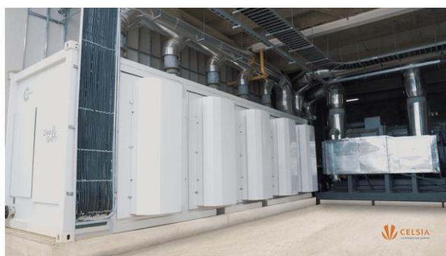
Figura 18. Distritos térmicos Nuestra Montería
