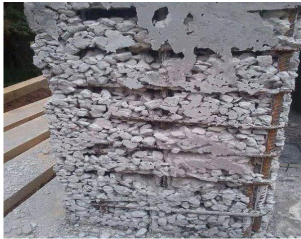
Ilustración 12. Segregación en el concreto
